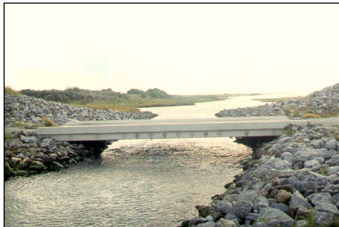
Figuur 1 Opening in de oostelijke dijk, waardoor zeewater de derde polder in en uit kan stromen.
